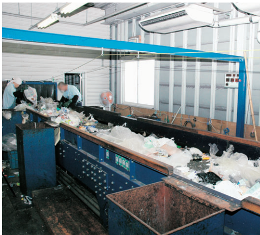
プラスチック製容器包装を選別作業している様子(プラスチック製容器包装中間処理施設)
