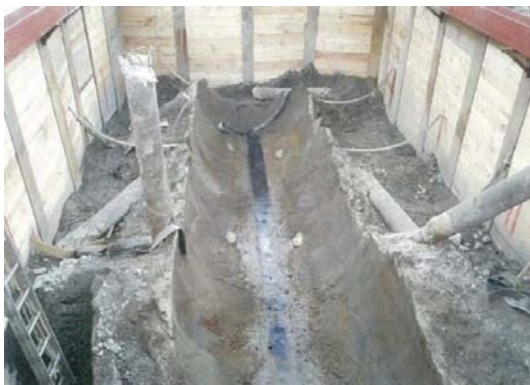
写真 2 倒壊した支柱
